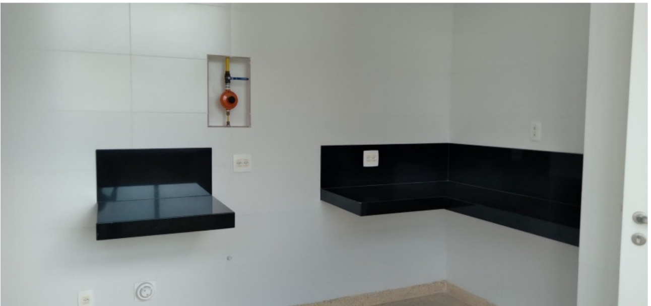
Foto XV: Exaustão da cozinha
