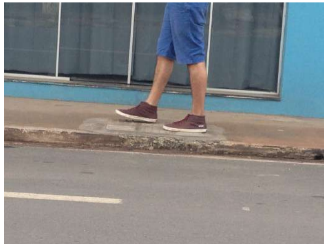
Figura 4 – Ladrilhos hidráulicos submetidos ao tráfego de pessoas sobre a calçada.
