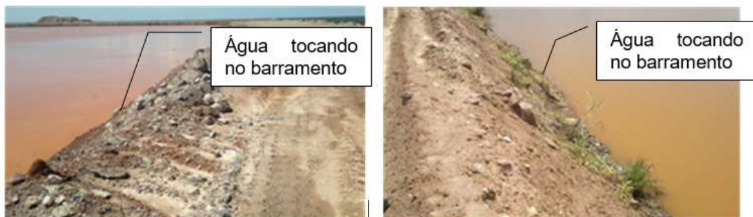
Figura 7 – Água tocando no barramento em condições normais.
