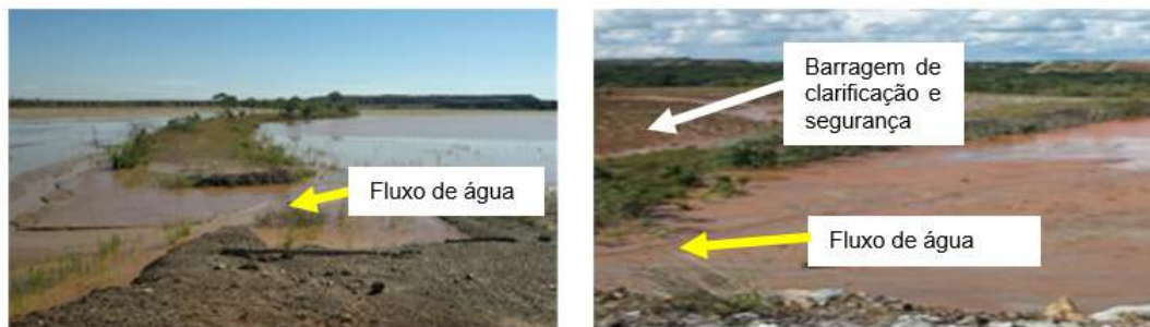
Figura 13 – Barragem dupla: adensamento e clarificação e segurança. Fonte: Próprio Autor (2017).
