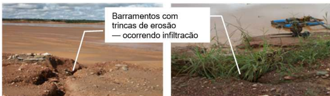
Figura 8 – Água tocando no barramento com problemas.
